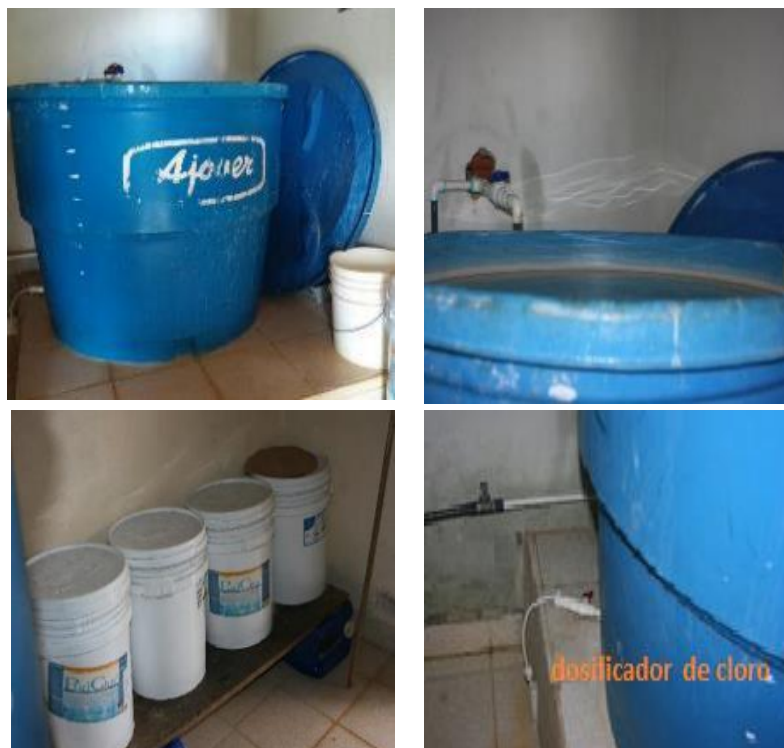
Figura 5.11. Aquí se encuentra la planta potabilizadora del agua con coordenadas N 6° 7' 56,712" W 75° 36' 33,044" (fuente clara)
