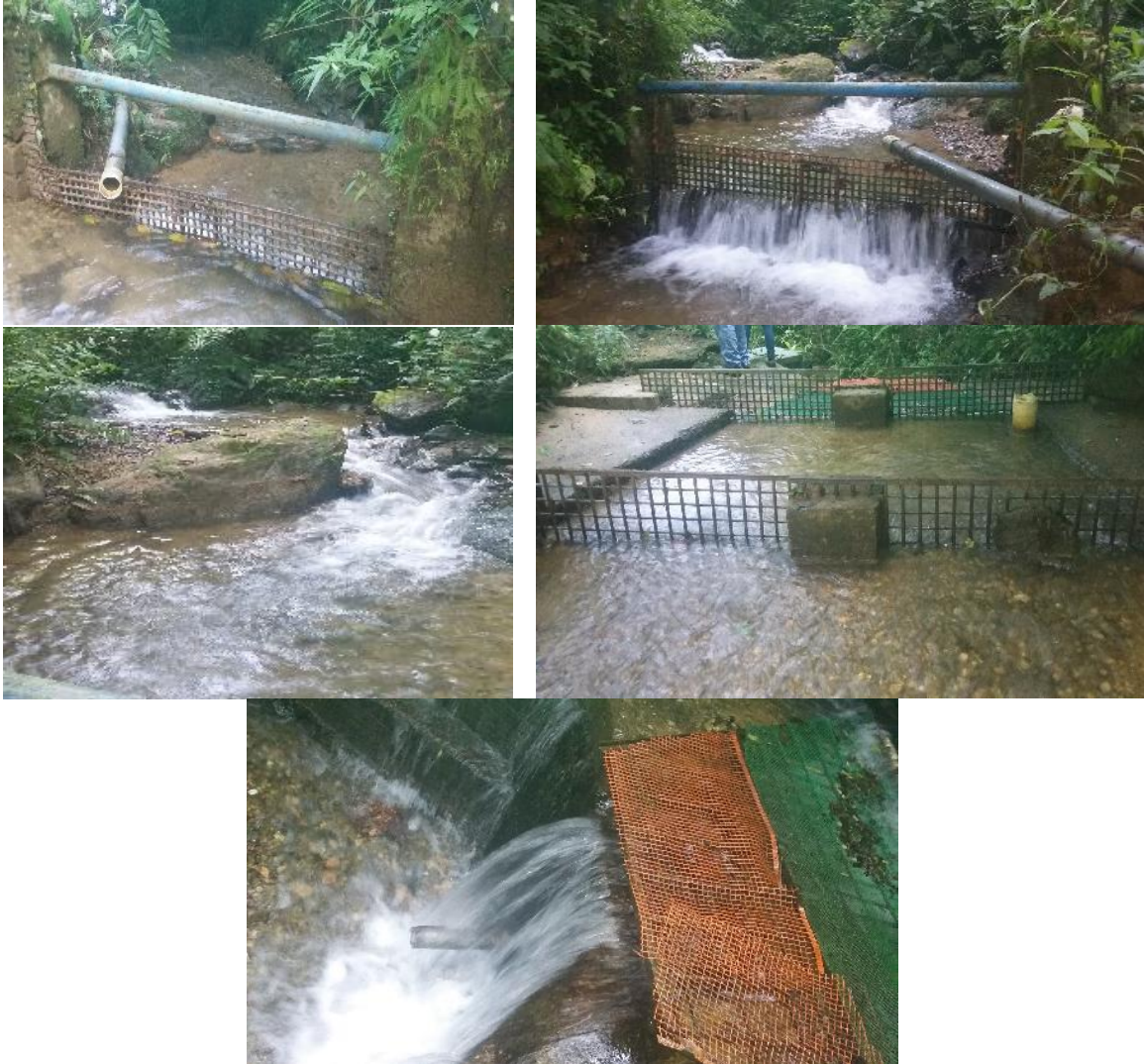
Figura 5.39. Bocatoma La Selva N 6° 7' 21,08" W 75° 36' 9,7636"
