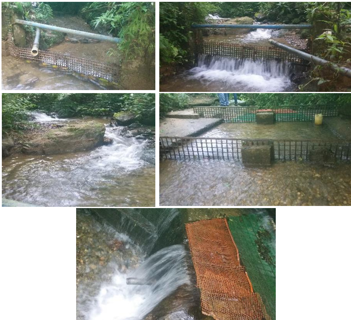
Figura 5.42. Bocatoma La Selva N 6° 7' 21,08" W 75° 36' 9,7636"
