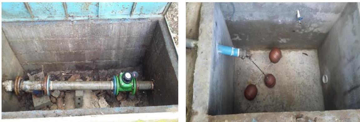
Figura 5.18. Macro medidor, Bypass
