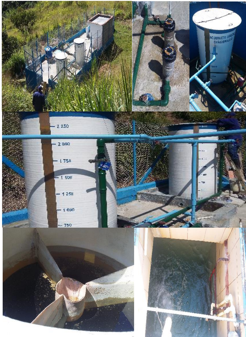
Figura 5.41. Planta Potabilizadora Coordenadas N 6°8'15.972" W75°37'27.37"
