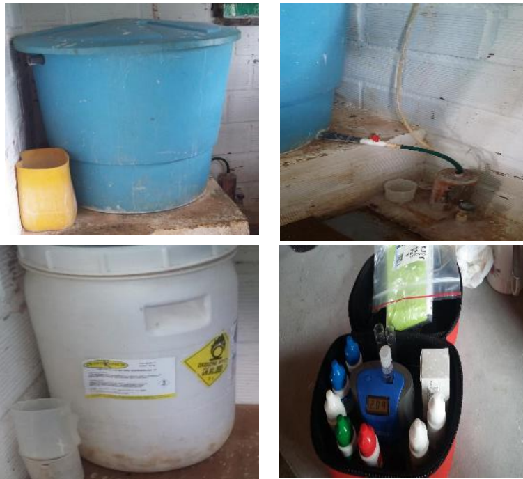
Figura 5.17. Tanque Dosificador de Cloro, Indicador de Cl Y pH. Coordenadas Planta Potabilizadora N 6°8'2.8688" y W 75°36'0.2628"
