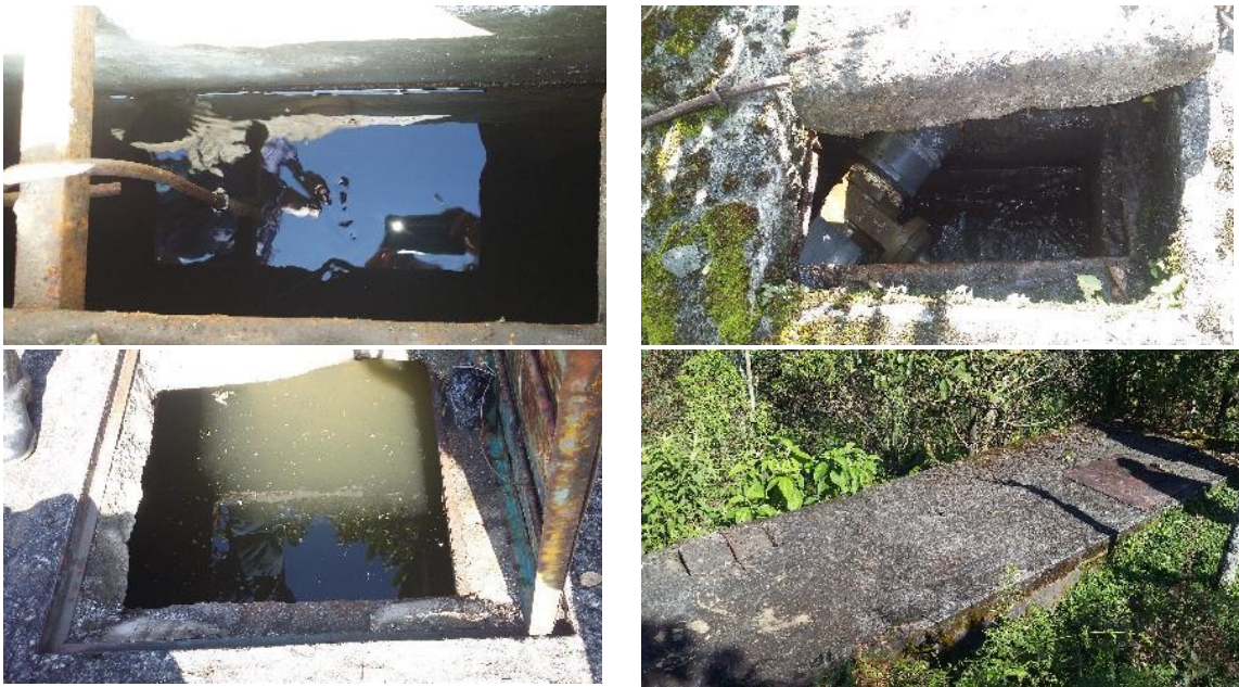
Figura 5.40. Tanque Desarenador Coordenadas N 6°7'25.8276" W75°36'10.998"
