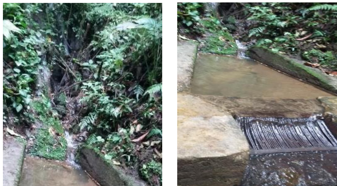
Figura 5.19. Bocatoma y Desarenador Coordenadas N 6°7'43.2912" W 75°36'52.5132".
