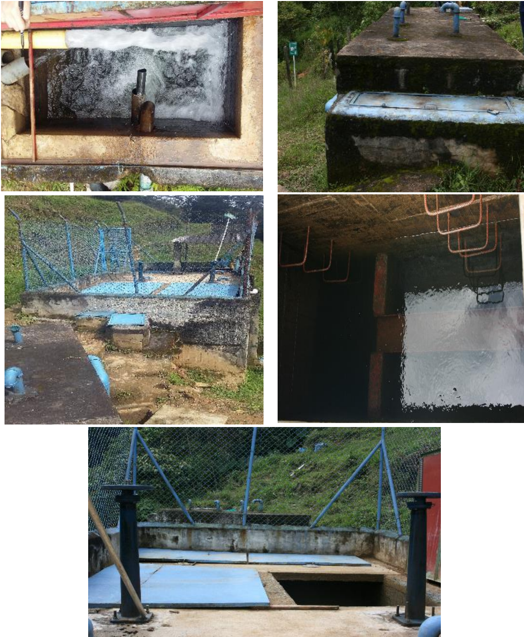
Figura 5.10. Desarenador: coordenadas N 6° 7' 50,1168" y W 75° 36' 34,0632" (Loma los Henaos La Doctora)
