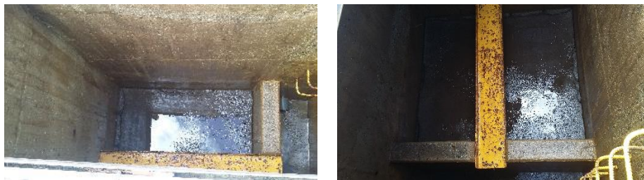
Figura 5.37. Tanque filtro N 6°8'25.3752" W 75°35'52.8576"
