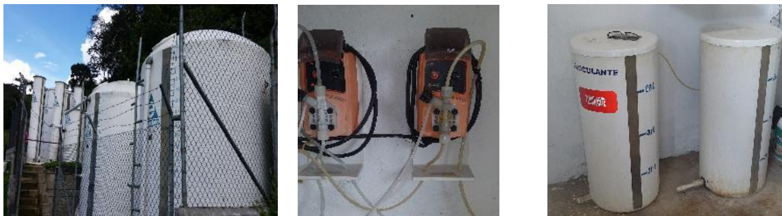
Figura 5.38. Planta Potabilizadora Coordenadas N 6°8'46.662" W 75°35'55.9536"
