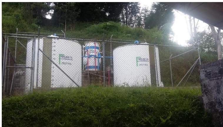
Figura 5.21. Planta potabilizadora coordenadas N 6° 7'52.212" W 75°37'6.6216"
