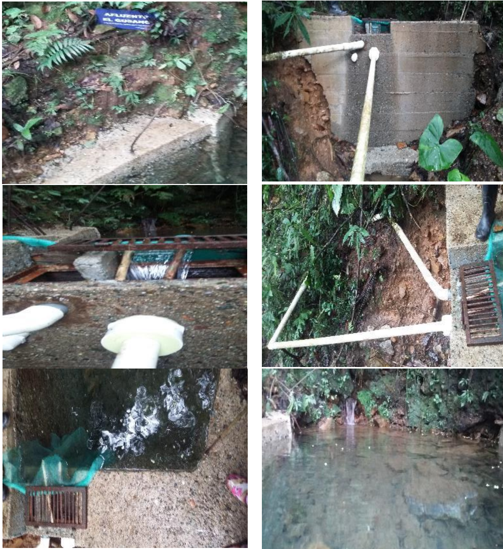
Figura 5.13. Bocatoma Afluyente El Gusano Coordenadas N 6° 7' 53.5692" Y W 75° 35' 44.4408"
