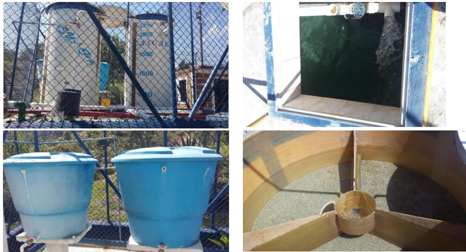
Figura 5.45. Planta Potabilizadora Coordenadas N 6°7'16.5192" W 75°37'40.0728"
