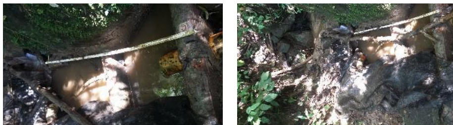
Figura 5.47. Bocatoma #1 N 6° 8'26.7108" W 75° 35'40.9236"
