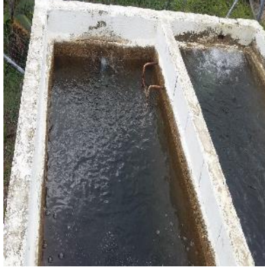
Figura 5.16. Filtros del acueducto coordenadas N 6° 8' 2,814" W 75°35'55.7484"
