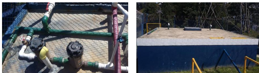
Figura 5.46. Planta Potabilizadora Coordenadas N 6°7'16.5192" W 75°37'40.0728"
