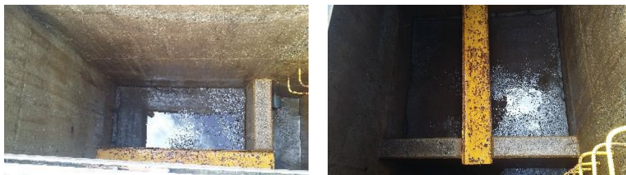
Figura 5.28. Tanque de filtración N 6°8'25.3752" W 75°35'52.8576"
